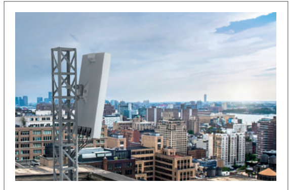
Fig. 20. Antennes massive MIMO.
